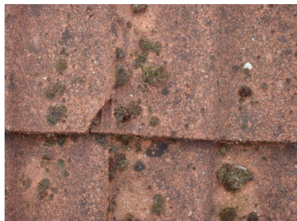
Foto 6 Er zijn meerdere gebroken dakpannen aangetroffen.
