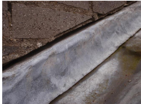
Foto 10 Plaatselijk ontbreekt de lintvoeg.
