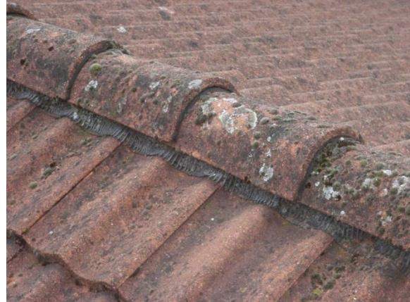
Foto 8 De nokvorsten zijn plaatselijk afgekit.
