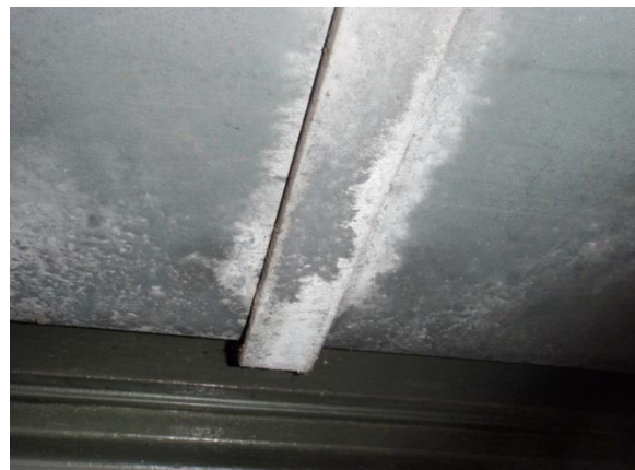
Foto 18 De conditie van de gootbeugels is redelijk.
